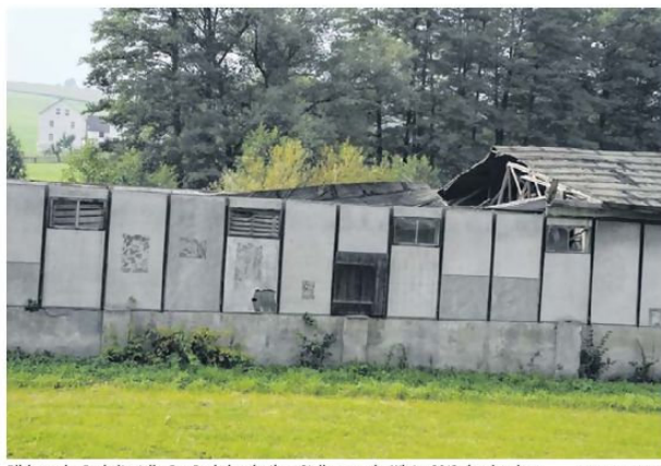
Blick von der Bushaltestelle. Das Dach der einstigen Stallung war im Winter 2012 eingebrochen. FOTOS: FRANCO MARTIN
